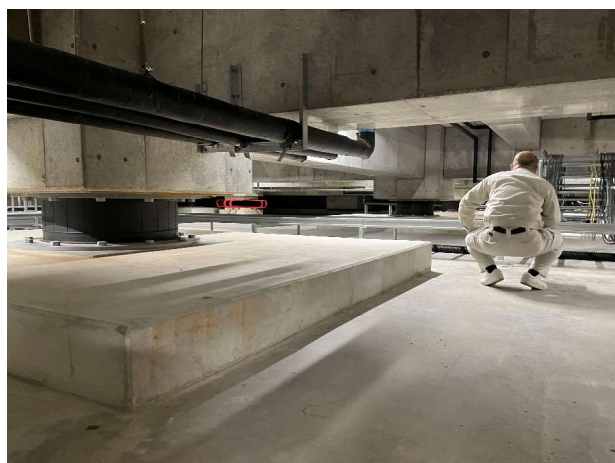
写真-3 地下の耐震設備
