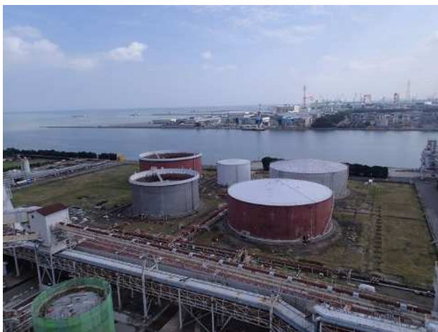
写真-1 燃料タンクヤード設備(撤去前)
